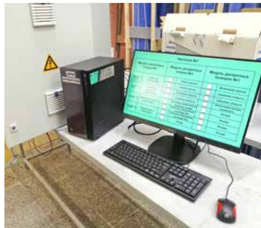
Автоматизированное рабочее место (изготовитель ООО «Полус Автоматика»)
