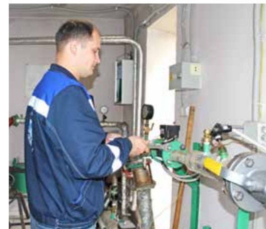
Обслуживание теплового узла. Инженер-метролог А.В. Гульба
