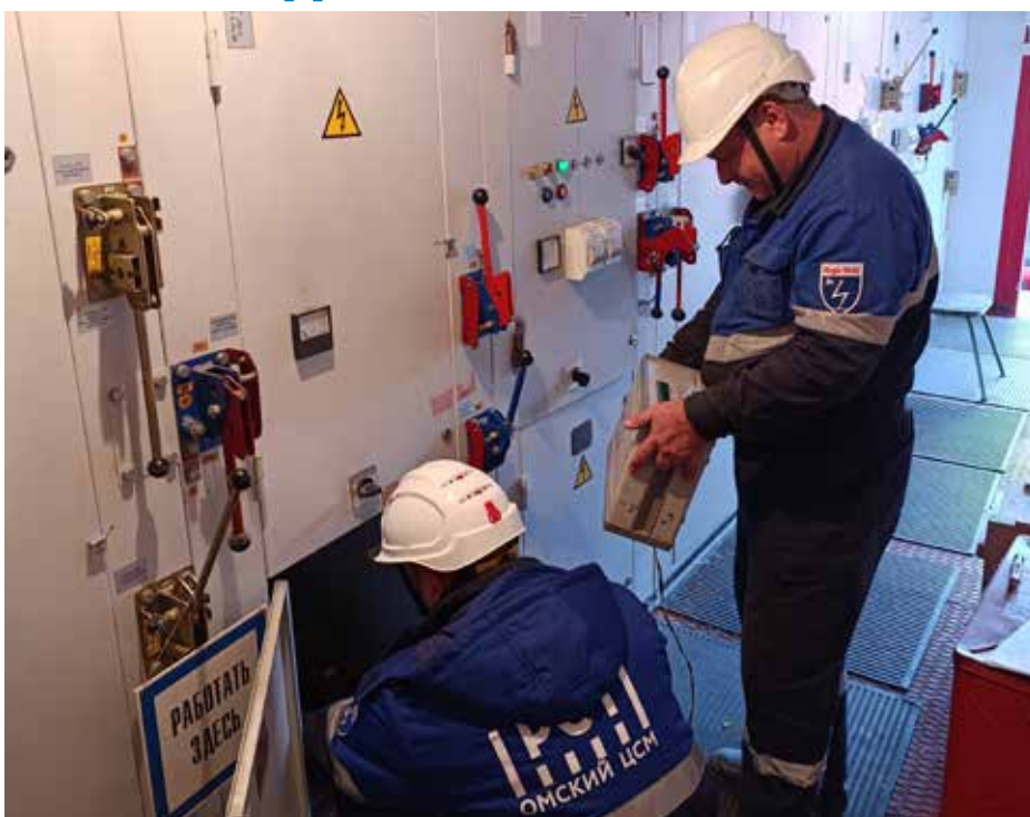
Испытания электрооборудования проводят специалисты ИЛ Омского ЦСМ
